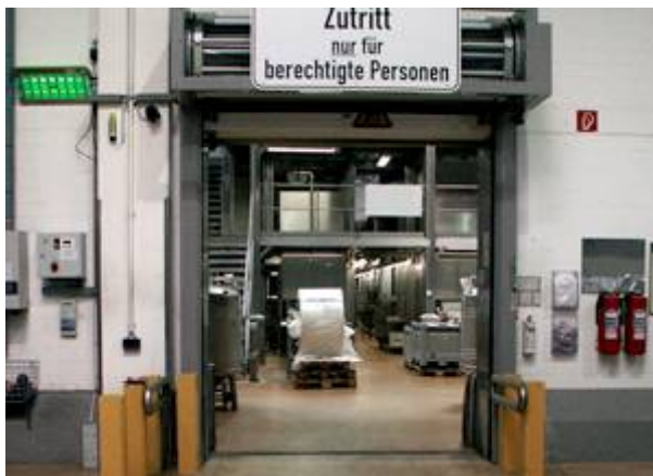
Rolltor mit Lichtgitter (berührungslos wirkende Schutzeinrichtung) und Bewegungsmeldern (oben links und rechts), die den gesamten Bereich vor dem Tor erfassen
